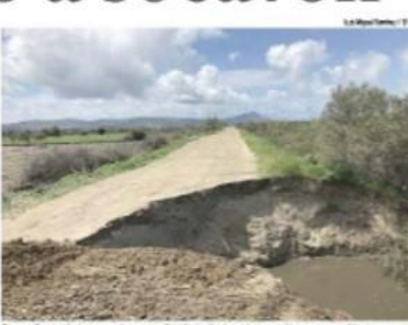
Problemas de drenaje provocan el agrietamiento de la tierra y socavones que se afianzan con el paso de los días.
